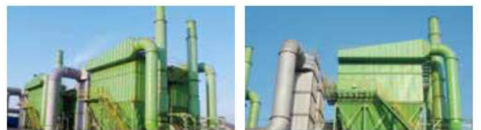
公害防止設備 (集塵機)
